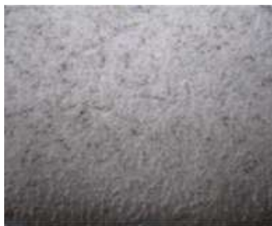
Рисунок 5.2. Дефект бетонной поверхности типа «апельсиновая корка»
