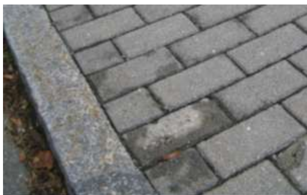
Рисунок 5.7. Желто-коричневые пятна на бетонных изделиях
